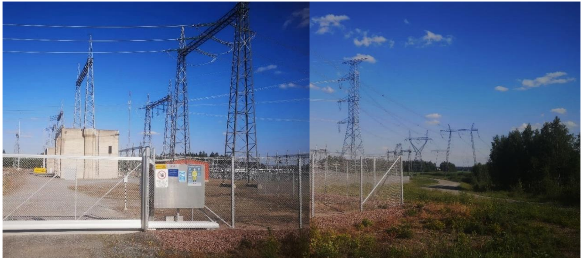
Kuva 35. Kuvauspiste H. Sähköaseman ympäristön nykytila; sähköaseman aidattua teknistä aluetta rakennuksineen sekä maisemassa voimakkaasti erottuvat voimalinjat (ilmajohdot rakenteineen ja aukeineen).
