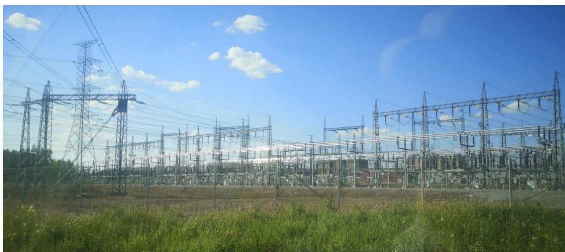
Kuva 25. Kuvauspiste G, ks. kartta kuva 19 Sähköaseman ympäristö on nykyinen, voimakkaasti rakennettu tekninen alue. Hankkeen ilmajohto (vaihtoehto maakaapelille) on suunniteltu liitettäväksi sähköasemaan. Näkymä Alamäentieltä pohjoiseen sähköaseman ympäristössä.
